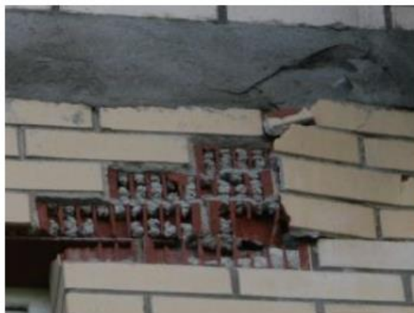
Рисунок 3. Облицовочные кирпичи с пустотами, заполненными раствором.
