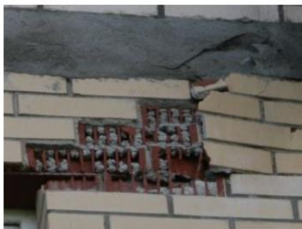
Рисунок 3. Облицовочные кирпичи с пустотами, заполненными раствором.
